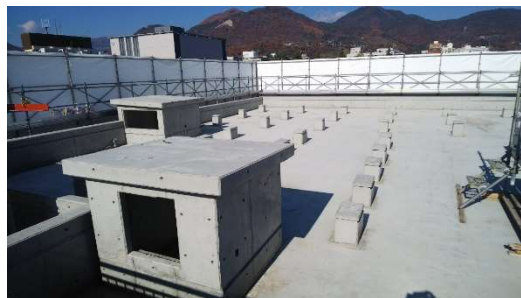
屋上 小さなコンクリートの台は空調機 室外機及びソーラーパネル設置用の架台
